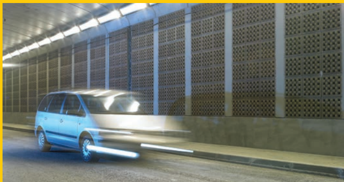
Rivestimento fonoassorbente in una galleria a Torino.
