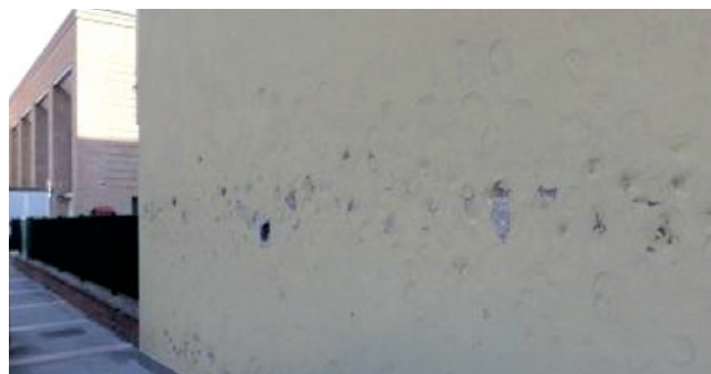
Isolamento a cappotto tradizionale danneggiato in superficie.
