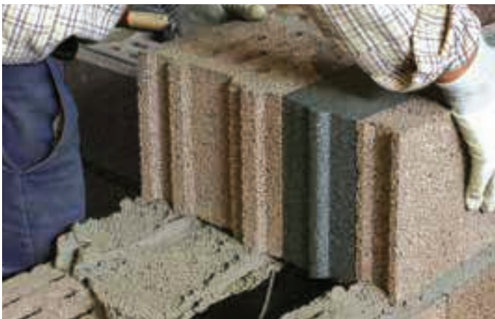
Posa del blocco con striscia isolante e traliccio metallico ogni due corsi.
