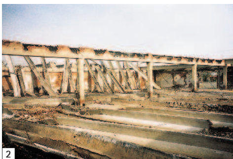
1. Planimetria del fabbricato interessato dall'incendio. La compartimentazione tagliafuoco tra produzione e magazzino è stata progettata dall'ing. L. Gambogi. 2. Vista generale del fabbricato distrutto dall'incendio. 3. Differente comportamento delle murature in laterizio ed in Lecablocco Tagliafuoco nella zona direttamente interessata dall'incendio.
